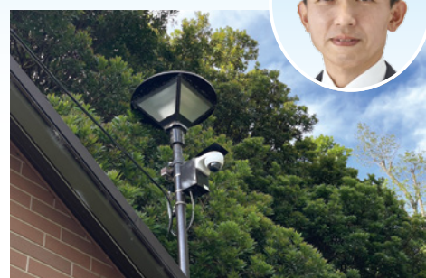
▲公園に設置している防犯カメラ
