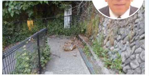
▲ほたる坂の落石の様子
