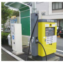
電気自動車用急速充電器
