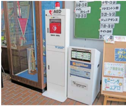
▲中央体育館に設置されているAED
