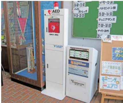
▲中央体育館に設置されているAED
