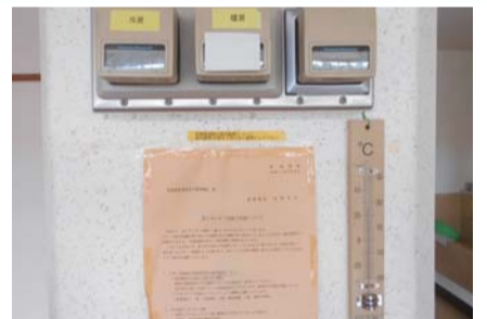
▲地域会館の室内空調設備の様子
