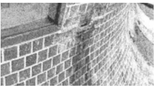
▲庁舎の雨漏り箇所
