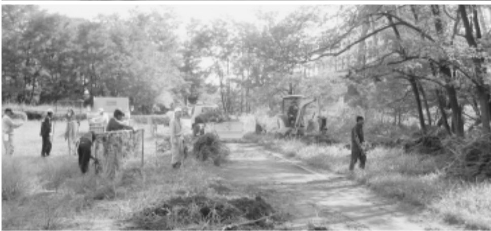
上 台風9号による多摩川中央公園被害状況 (H19.9.7撮影) 下 ボランティアによる復旧作業 (H19.10.6)
