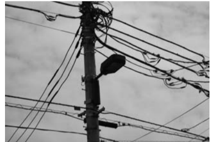
▲加美立体通りのLED照明灯
