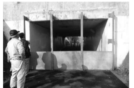
▲水害防護壁設置の様子
