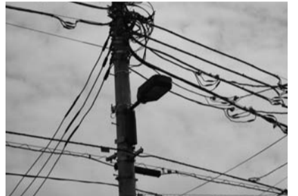
▲加美立体通りのLED照明灯
