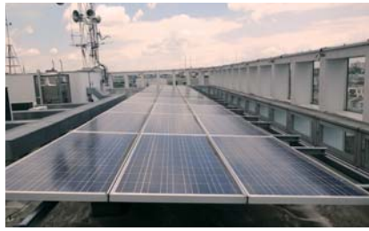
▲市役所屋上のソーラーパネル
