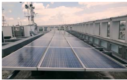
▲市役所屋上のソーラーパネル
