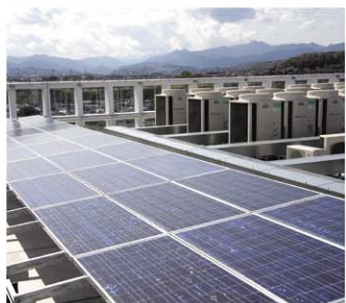
屋上太陽光発電システム
