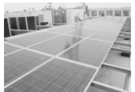
▲新庁舎屋上の太陽光発電システム
