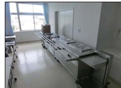
【バイキング設備】
